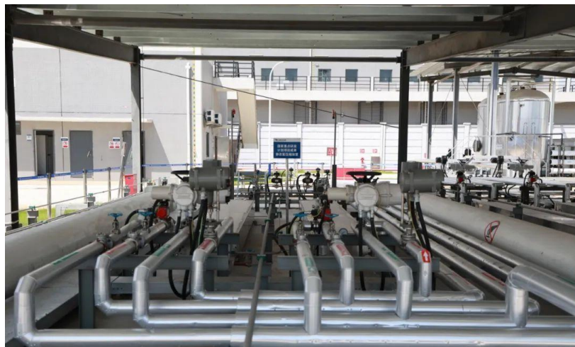
全国首个固态氢储能电氢智慧能源站-小虎岛电氢智慧能源站
