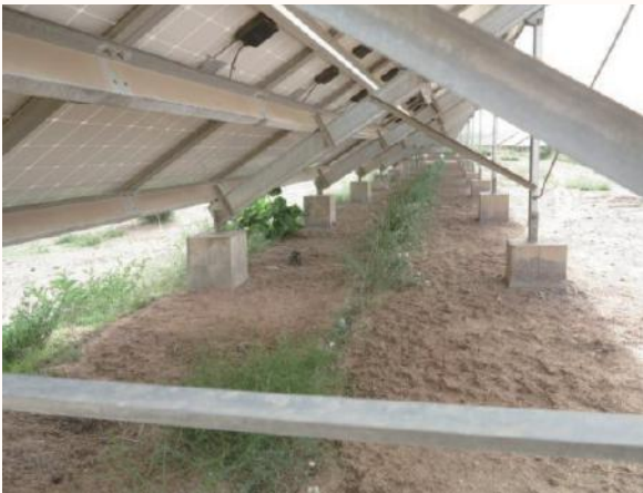
c 宁夏大唐青铜峡光伏电站
