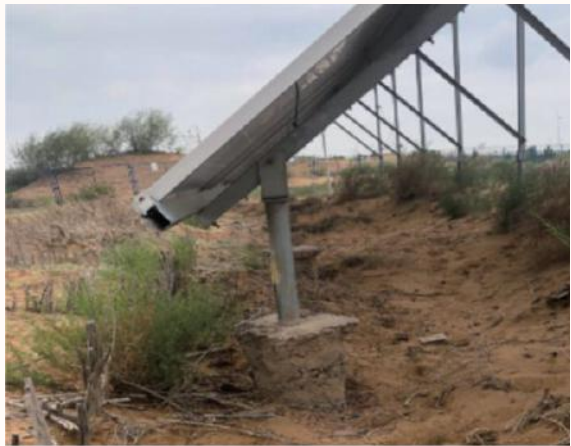
c 光伏板狭管效应造成桩基裸露
