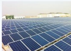
电站系统应用
