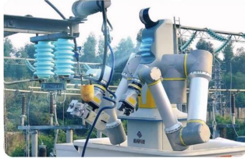
图44： 公司“擎天”配网带电作业系统
