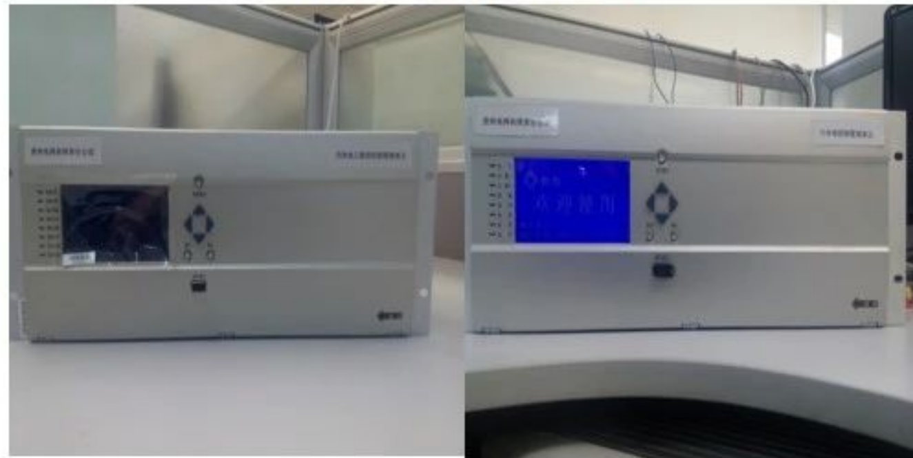
冷热电联供控制终端
