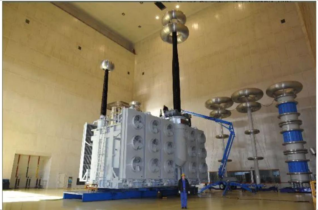
图12. 1500MVA 特高压变压器示意图
