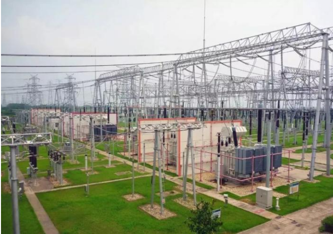
图32. 变电站现场图
