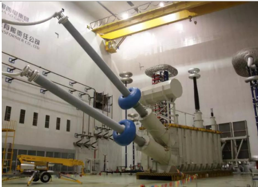
图21. 灵州-绍兴±800kV 特高压工程换流变压器
