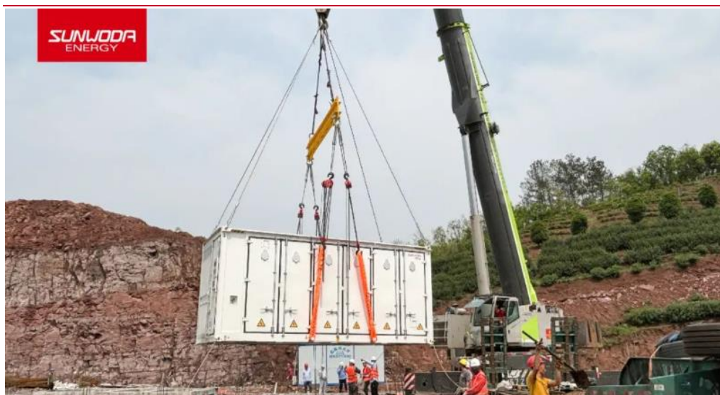
图表40：浙江金华 200MW/400MWh 电网侧储能项目图
