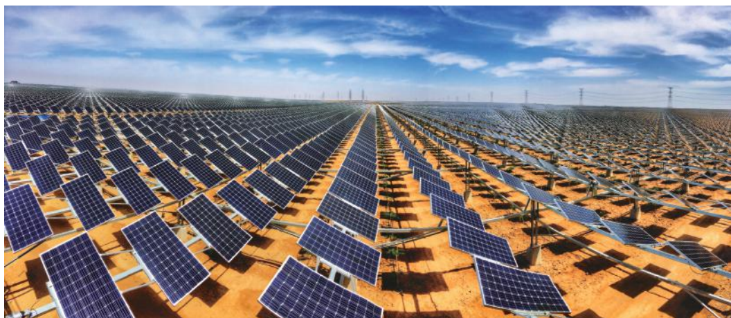
图 4-4 全球最大单体农光互补电站——位于宁夏银川的宝丰农光一体光伏电站
