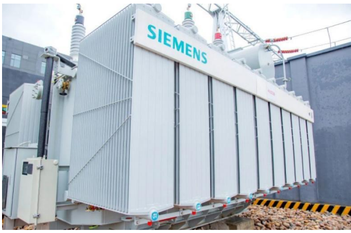
图表 52 润泽科技 110KV 变电站
