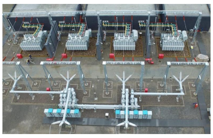
图表 53 润泽科技 110KV 变电站
