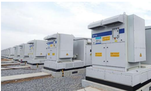
图 30：宁夏中核汇能 100MW/200MWh 储能电站
