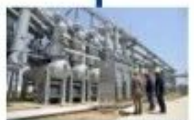
整站辅助监控
