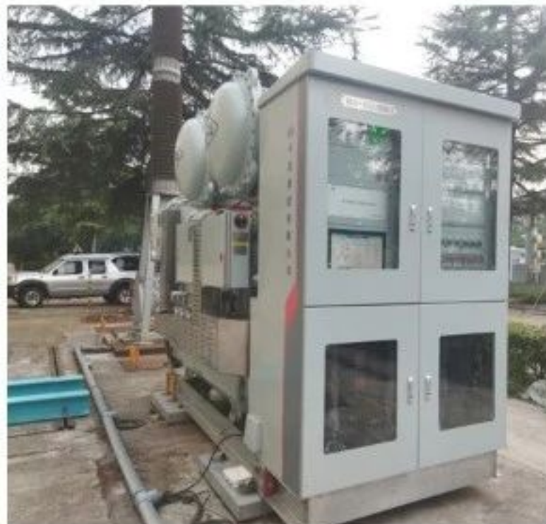
监测系统户外长期带电运行测试
