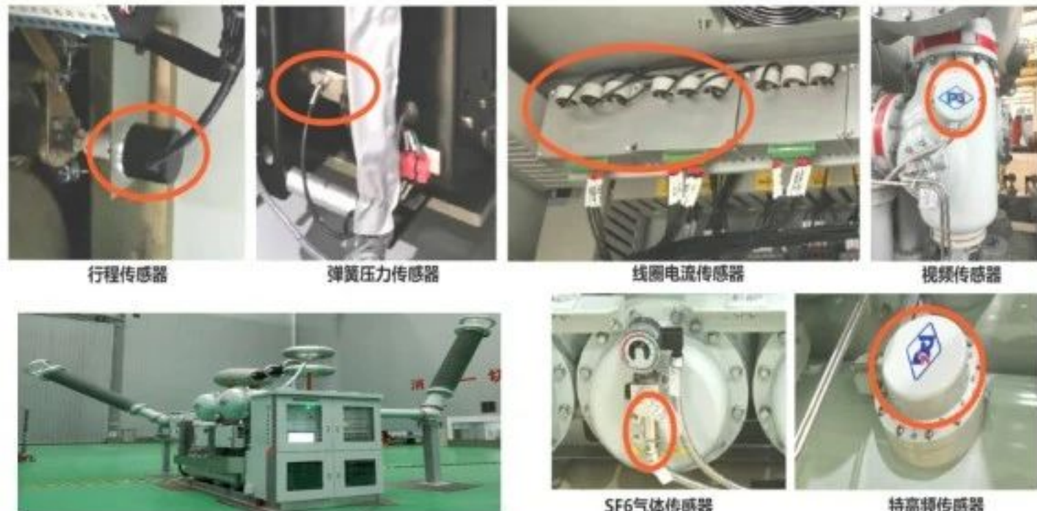
252kV GIS状态全面感知
