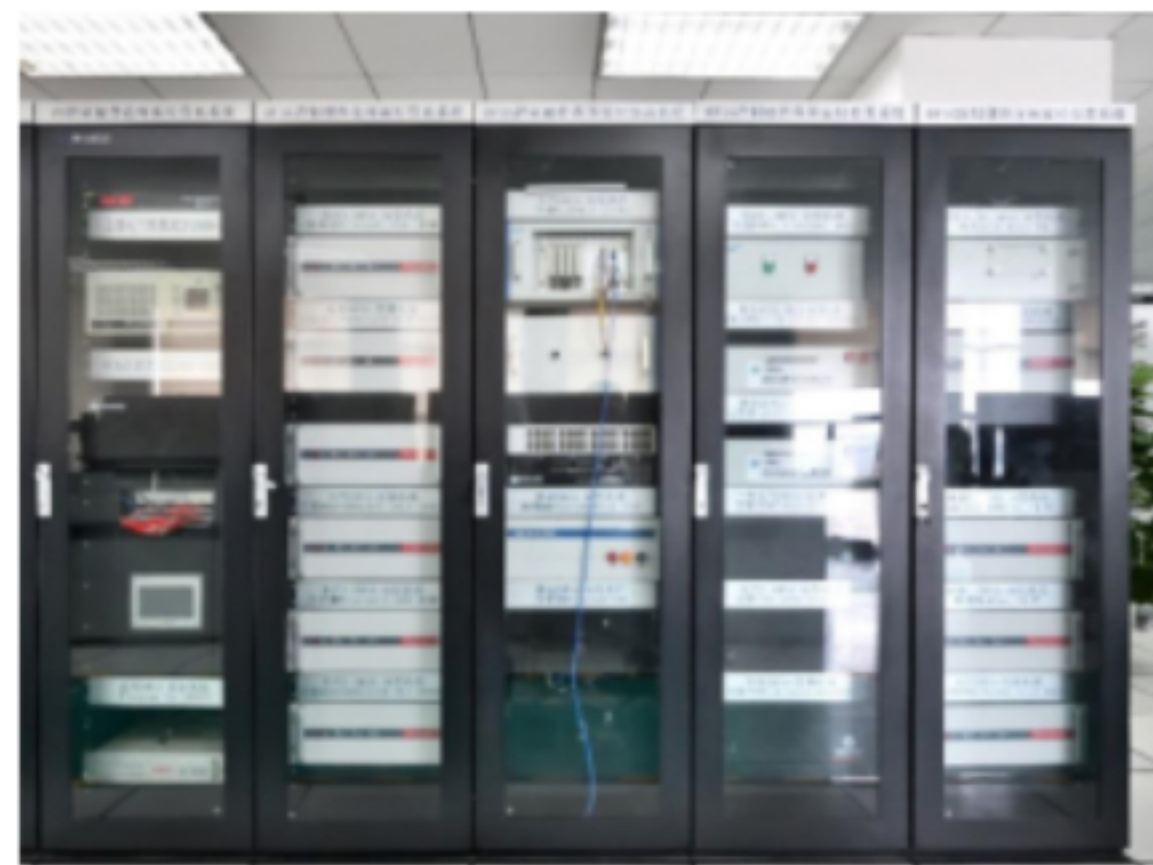
实际新能源发电控制器
